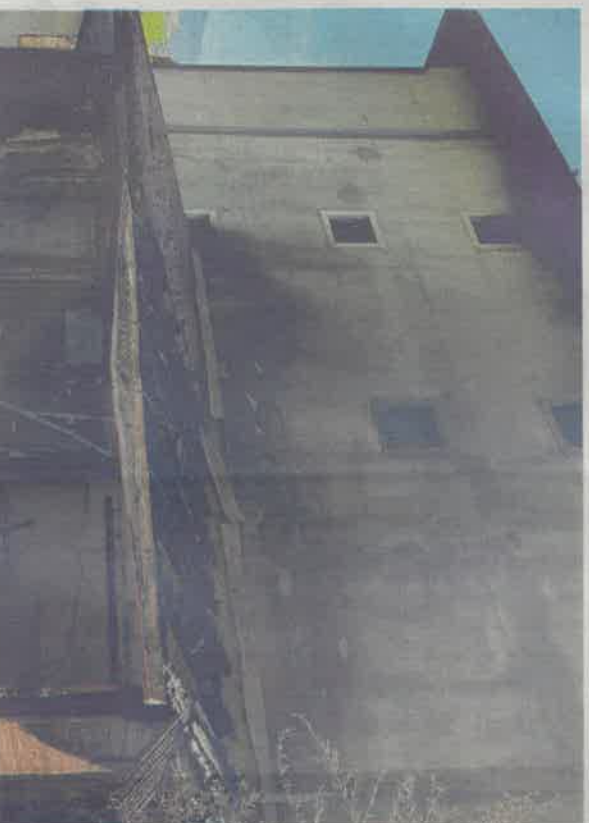
L'incendio La struttura di Villa è stata incendiata a partire da due punti diversi
