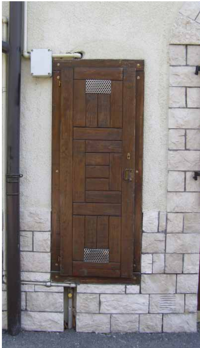
CASSETTA DI ISPEZIONE RIVESTITA IN LEGNO - FRAZIONE DI CASTELLANO
