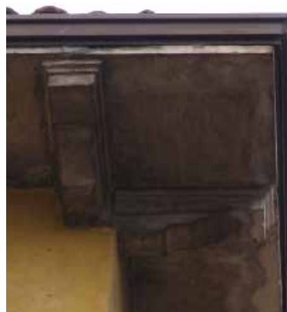
CORNICIONE TRADIZIONALE CON MENSOLE IN LEGNO INTONACA- TO
